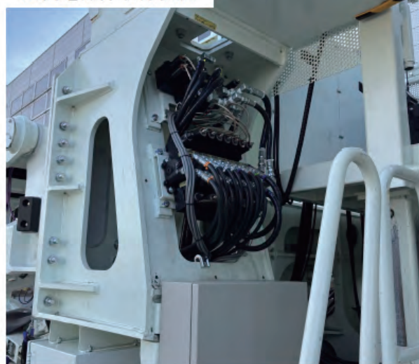
比例電磁弁取付状況
