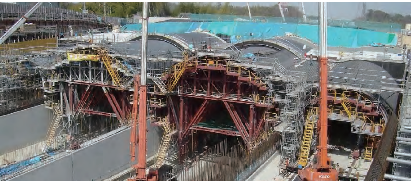
4連メガネトンネル移動セントル
